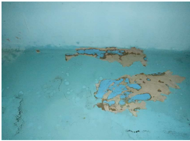
배수지2지 하부슬래브 도장박리
