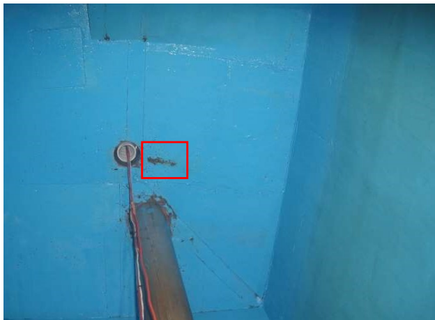
배수지1지 상부슬래브 철근노출
