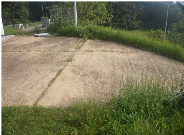
장내포장 파손(출입구 받침) 2021년 정밀
