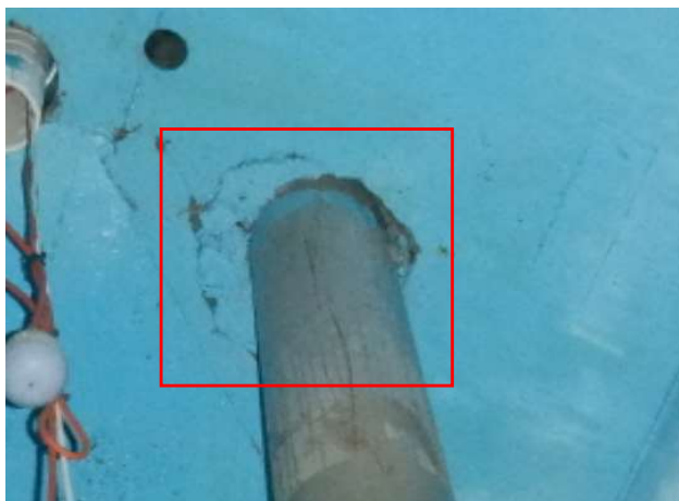
배수지2지 상부슬래브 박락
