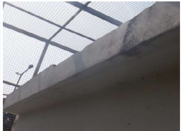
계단실 외부 상부슬래브 파손(모르타르)
