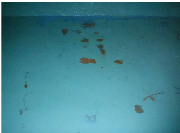
배수지1지 하부슬래브 도장박리
