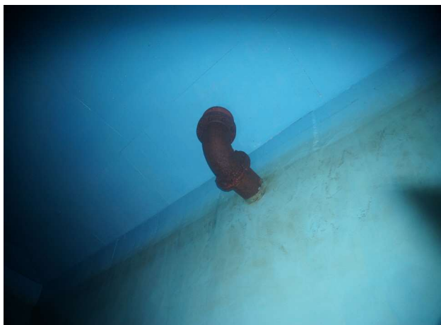
1지 배수지 유입배관 관부식
