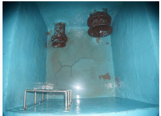
배수지1지 집수정 바닥슬래브 도장박리
