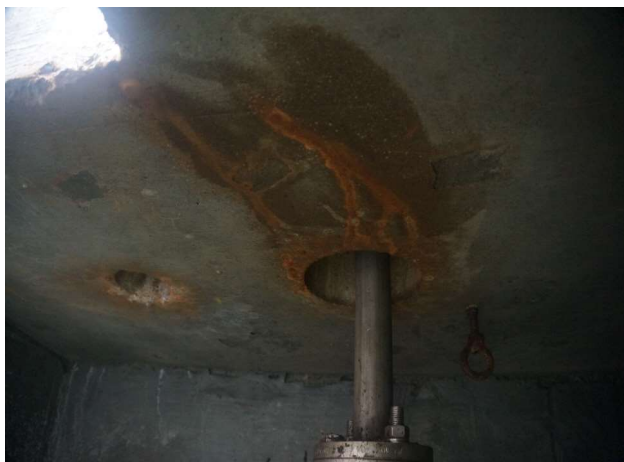
1지 유입밸브실 상부슬래브 누수흔적
