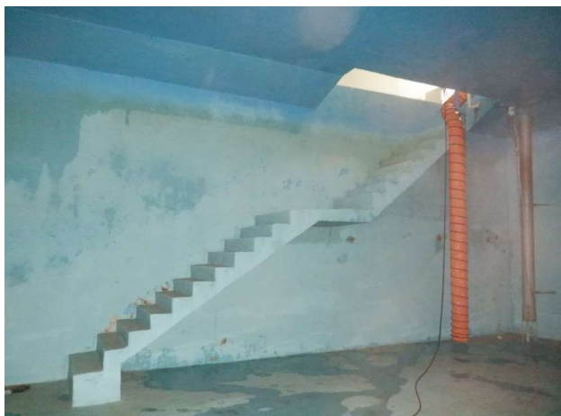
배수지 내부 안전난간 미설치
