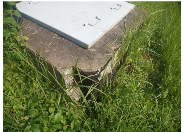
1지 유출밸브실 상부슬래브 상면 파손(모르타르)
