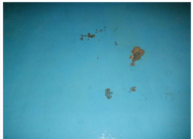
배수지1지 하부슬래브 도장박리
