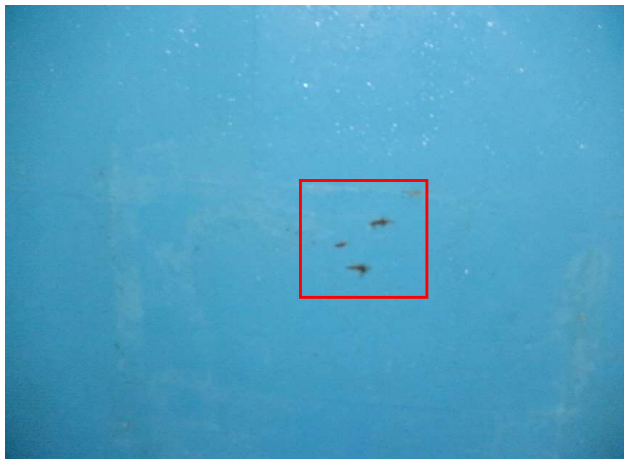
배수지2지 상부슬래브 녹
